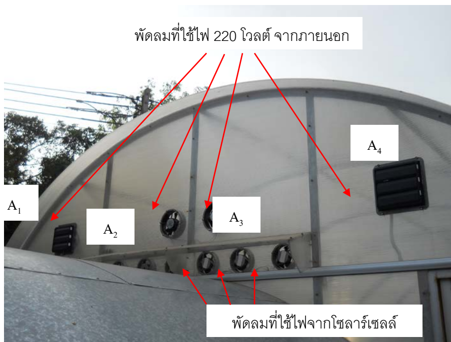
รูปที่ A1.2 พัดลมที่ใช้ไฟฟ้า 220 โวลต์ ที่ต้องเปิดเมื่ออุณหภูมิอากาศภายในโรงอบสูงเกินไป
