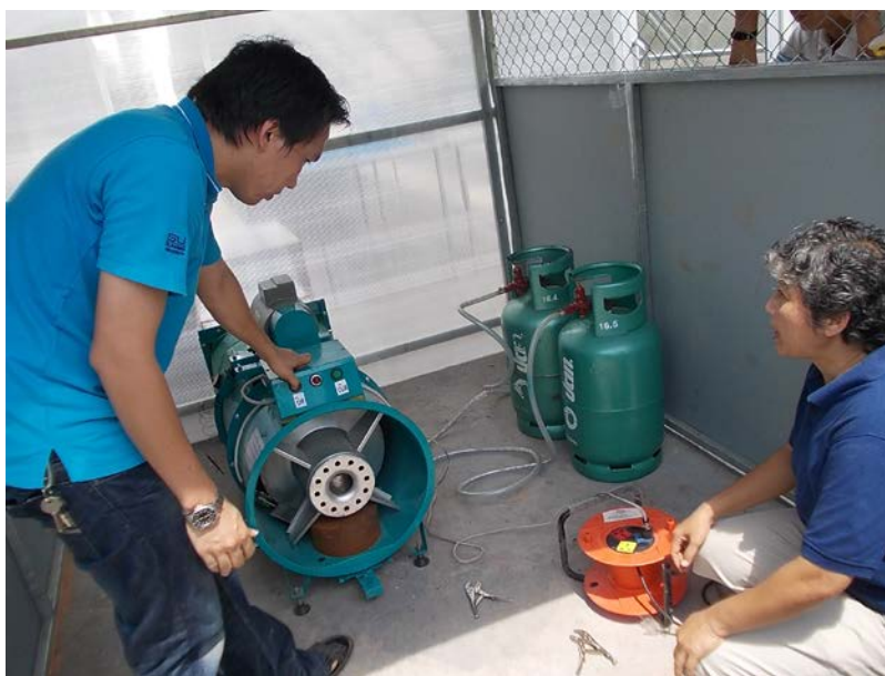
รูปที่ A1.4 เครื่องเผาไหม้แก๊สที่ต้องเปิดเมื่อความชื้นสัมพัทธ์ของอากาศสูงเกินไป
