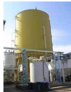
รูปที่ 3-10 โครงสร้างบ่อหมักที่เป็นถังเหล็ก
