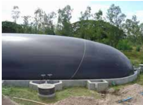
รูปที่ 5-32 Buffer tank
