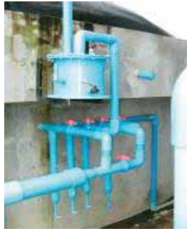
รูปที่ 5-38 ชุดควบคุมแรงดันบ่อเก็บก๊าซชีวภาพ
