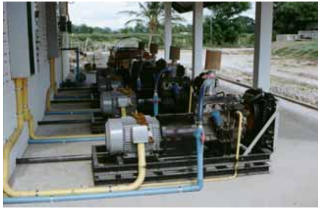
รูปที่ 5-46 ชุดผลิตพลังงานไฟฟ้าโดยเครื่องยนต์ใช้ก๊าซชีวภาพเป็นเชื้อเพลิง
