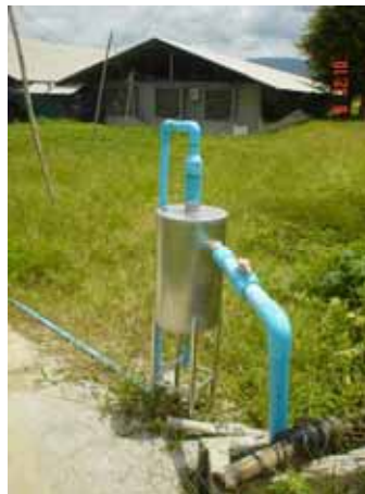
รูปที่ 5-31 ชุดดักและกรองสิ่งแปลกปลอมที่มากับก๊าซชีวภาพและดักน้ำก่อนส่งก๊าซไปใช้งาน
