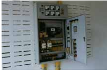
รูปที่ 5-45 ภายในตู้ควบคุมชุดผลิตพลังงานไฟฟ้า
