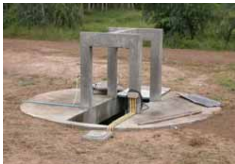
รูปที่ 5-24 บ่อรวมน้ำเสีย
