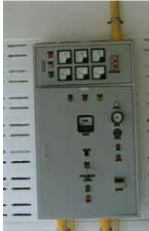
รูปที่ 5-44 ตู้ควบคุม
