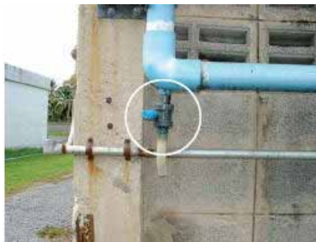
รูปที่ 5-49 จุดระบายน้ำที่ควบแน่นในเส้นออกจากท่อส่งก๊าซ
