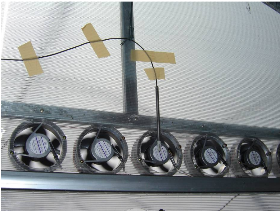
รูปที่ A9 พัดลมดูดอากาศ
