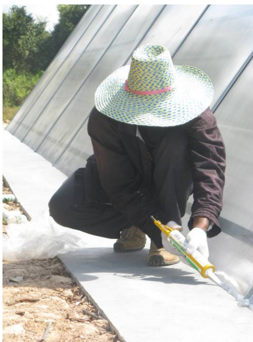
รูปที่ A8 การใช้ซิลิโคนอุดรอยร้าวที่แผ่นโพลีคาร์บอเนต
