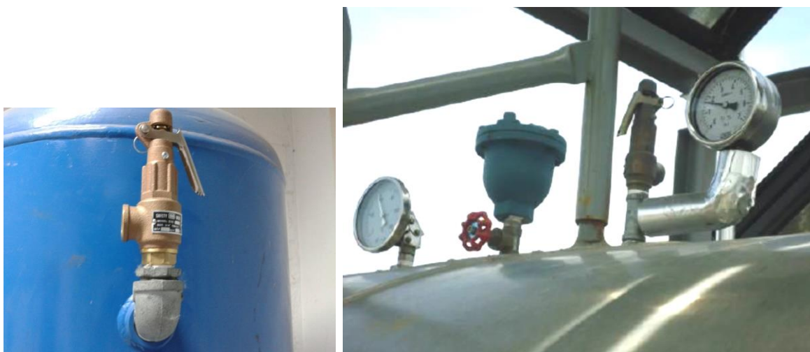
รูปที่ 8 แสดงการติดตั้งอุปกรณ์นิรภัย
