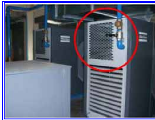
รูปที่ 6.1-17 สภาพหลังการปรับปรุงเครื่องอัดอากาศตัวใหม่ ขนาด 75 กิโลวัตต์
