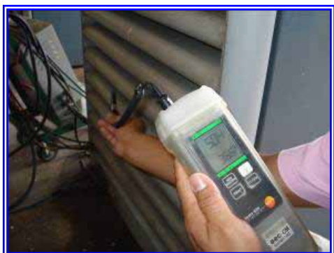
อุณหภูมิอากาศเข้าเครื่องอัดอากาศ No. 5 หลังปรับปรุง
