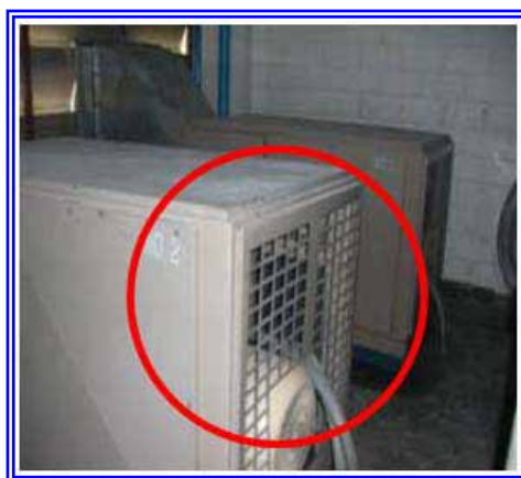
รูปที่ 6.1-16 สภาพเครื่องอัดอากาศก่อนการปรับปรุง
