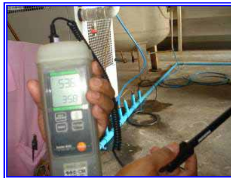
อุณหภูมิอากาศเข้าเครื่องอัดอากาศ No. 4 หลังปรับปรุง
