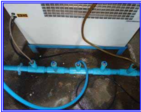
รูปที่ 6.2-2 จุดทางออกคอนเดนเสทของ Air Dryer
