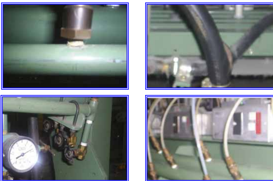
รูปที่ 6.2-15 จุดที่มีการรั่วไหลของอากาศอัดจากเครื่องกรอตัด ก่อนปรับปรุง
