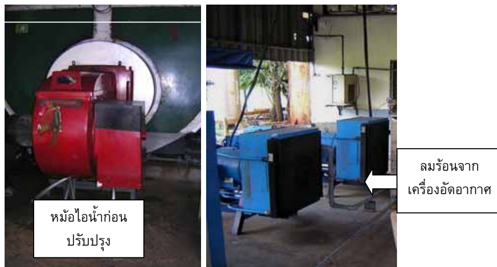
รูปที่ 6.1-18 หม้อไอน้ำและเครื่องอัดอากาศก่อนปรับปรุง
