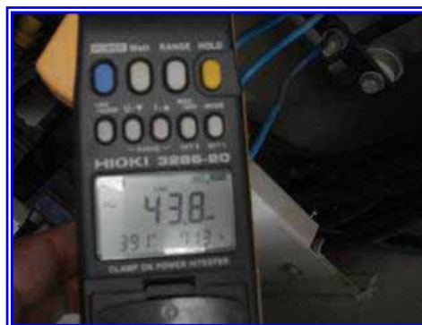
กำลังไฟฟ้าในช่วงมีโหลดของเครื่องอัดอากาศ No.5
