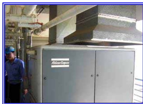
Exhaust Duct ปิดไม่สนิท
