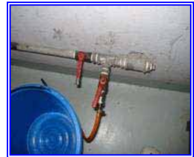
วาล์วท่อเมนลมเข้าเครื่องปั๊มสูญสุ
