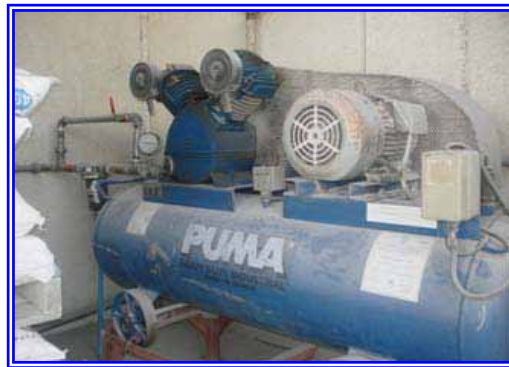
รูปที่ 6.4-17 เครื่องอัดอากาศสำหรับเครื่อง Packing ก่อนการปรับปรุง
