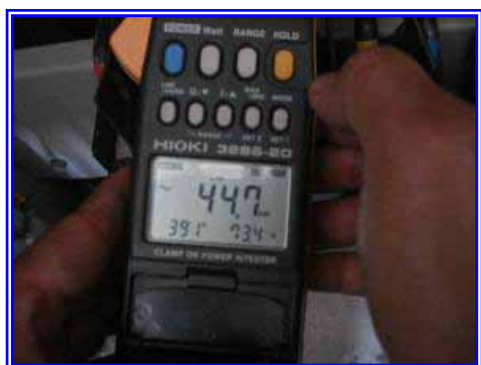
กำลังไฟฟ้าช่วงมีโหลดของเครื่องอัดอากาศ No. 5
