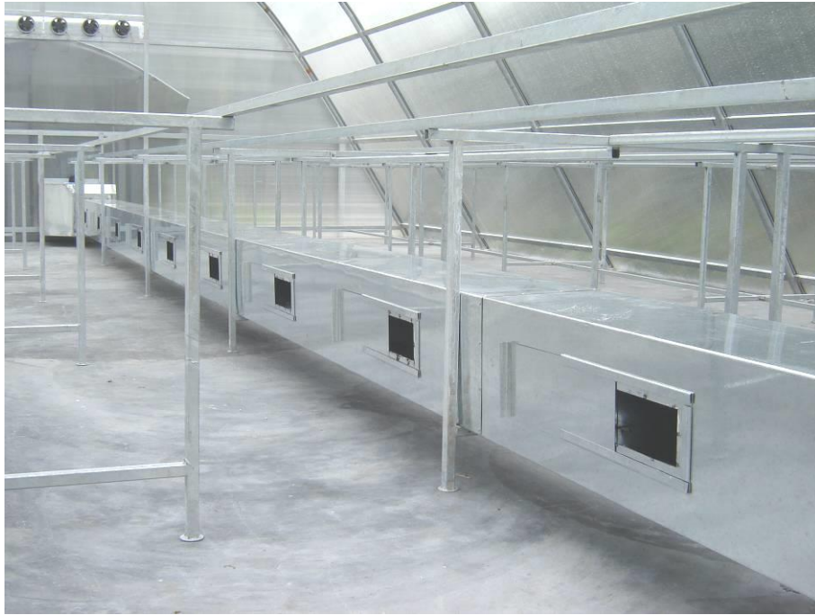
รูปที่ 54 ท่ออากาศสำหรับกระจายลมร้อนจากระบบความร้อนเสริมที่ติดตั้งภายในระบบบอบแห้งฯ แบบพพ.3
