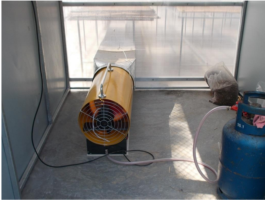
รูปที่ 56 เครื่องเผาไหม้แก๊สที่ติดตั้งภายในระบบบอบแห้งฯ
