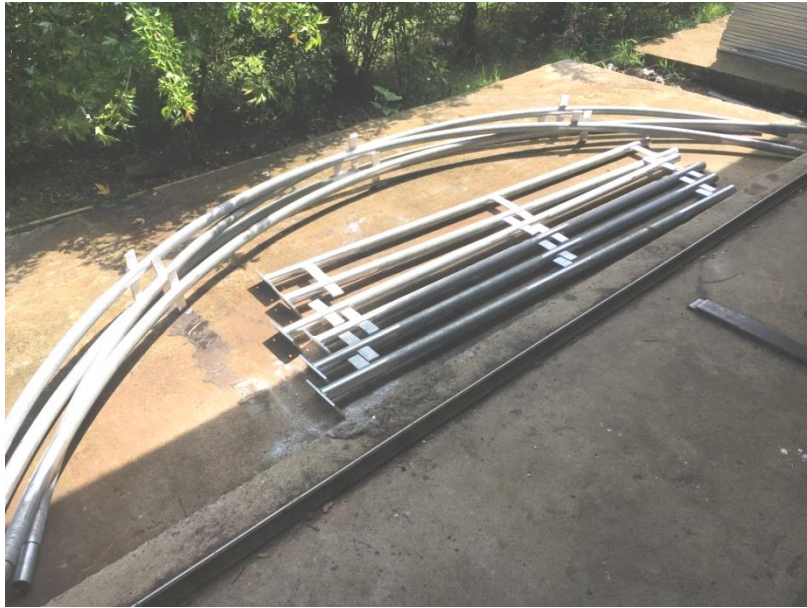
รูปที่ 27 เหล็กโครงหลังคา กับเสาเหล็กที่ซุบกัสนิมแล้ว
