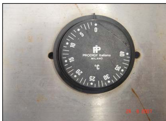
ภาพอุปกรณ์ควบคุมอุณหภูมิน้ำเย็นในปัจจุบัน
