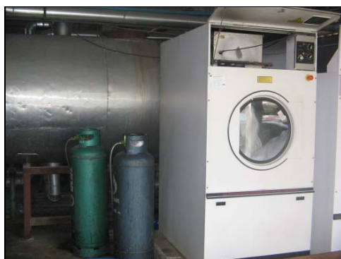
ภาพหลังการปรับปรุง (นำก๊าซหุงต้มที่เหลือไปใช้กับเครื่องอบผ้า)
