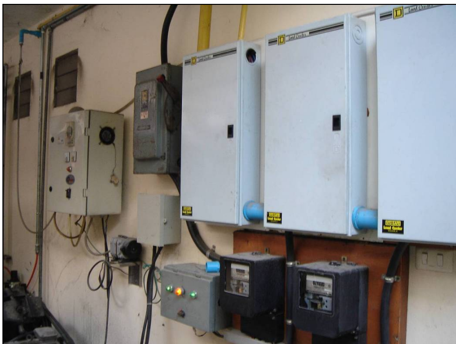
ภาพแสดงระบบไฟฟ้าที่ตู้จ่ายไฟฟ้า
