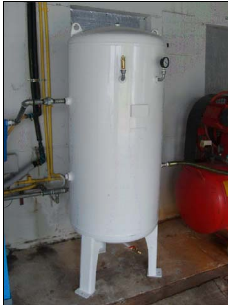
ภาพถังพักลมติดตั้งใช้งานกับปั๊มลม
