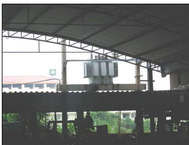
ภาพลักษณะการติดตั้งหม้อแปลงไฟฟ้า
