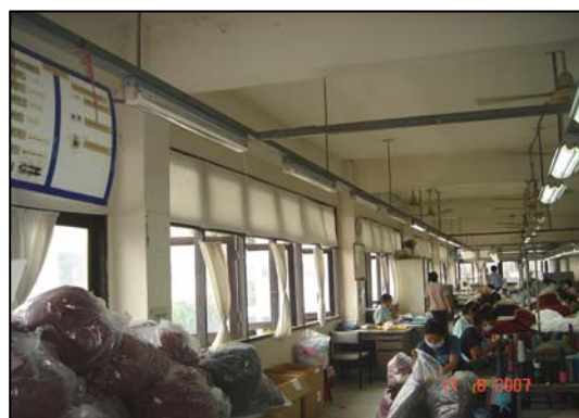
ภาพการติดตั้งสวิตช์ควบคุมประจําโคม และจำนวนโคมไฟฟ้ที่ปิดได้ในแผนกตรวจปะ
