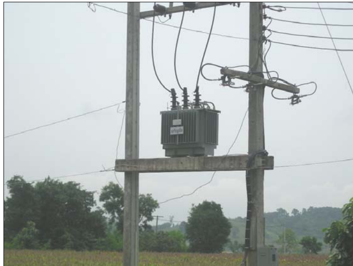
ภาพหม้อแปลงไฟฟ้าขนาด 250 kVA
