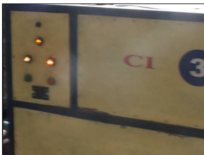
ภาพการปรับตั้งอุณหภูมิน้ำเย็นของ Chiller หลังปรับปรุง
