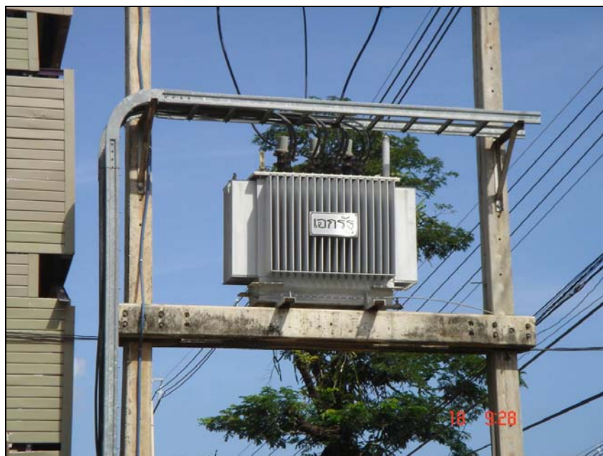
ภาพแสดงหม้อแปลงไฟฟ้าขนาด 500 kVA ของโรงงาน
