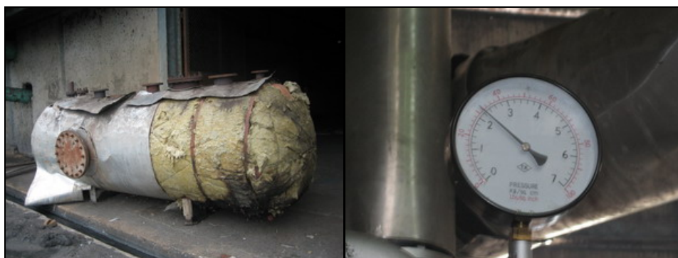
ภาพถัง Back Pressure ใบเก่า และแรงดันไอน้ำในถังที่ต่ำกว่า 3 บาร์
