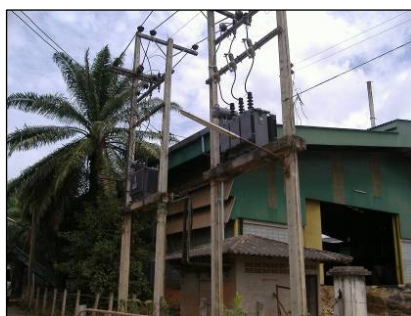
ภาพลักษณะการติดตั้งหม้อแปลง 2 ชุด
