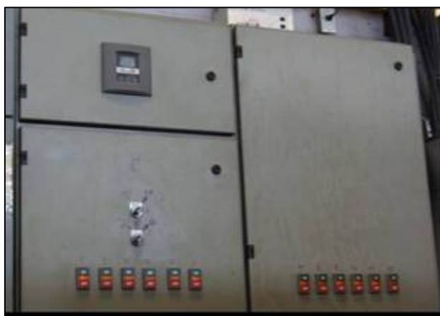
ภาพตู้ควบคุมไฟฟ้าที่แสดงค่าเพาเวอร์แฟคเตอร์
