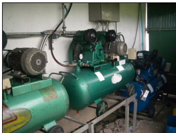
ภาพการใช้งานในระบบอัดอากาศ
