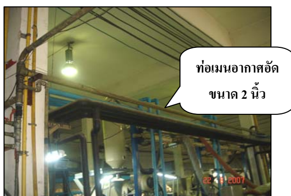
ภาพท่อเมนอากาศอัดภายในโรงงานก่อนการปรับปรุง
