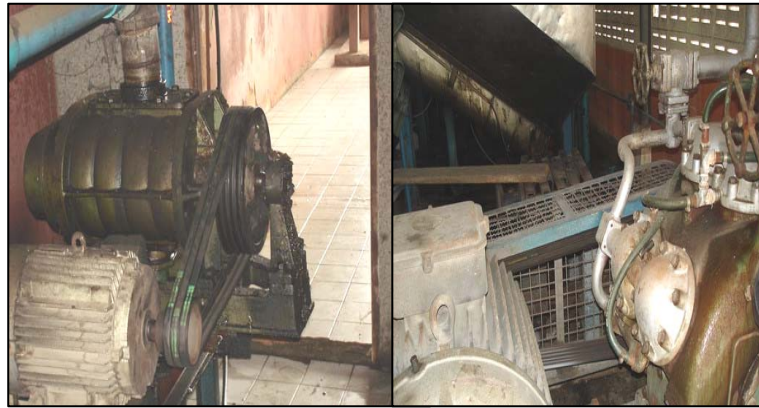
ภาพลักษณะของสายพานหลังการปรับปรุง
