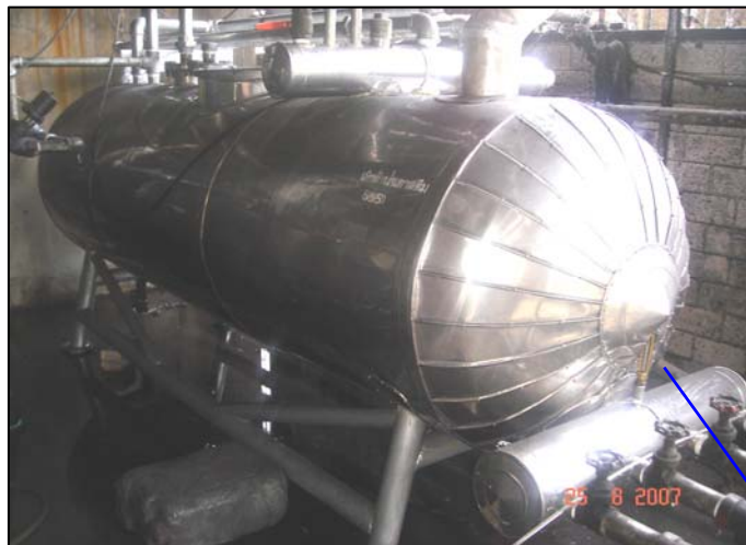
ภาพถังน้ำป้อนหม้อไอน้ำหลังปรับปรุง
