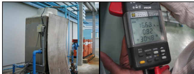
ภาพ Cooling Tower มีไม้กระดานปิดบังลม และการวัดแสดงกำลังไฟใช้งาน
