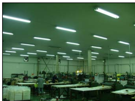
ภาพการเปิดใช้งานโคมไฟในหน่วยตัด
