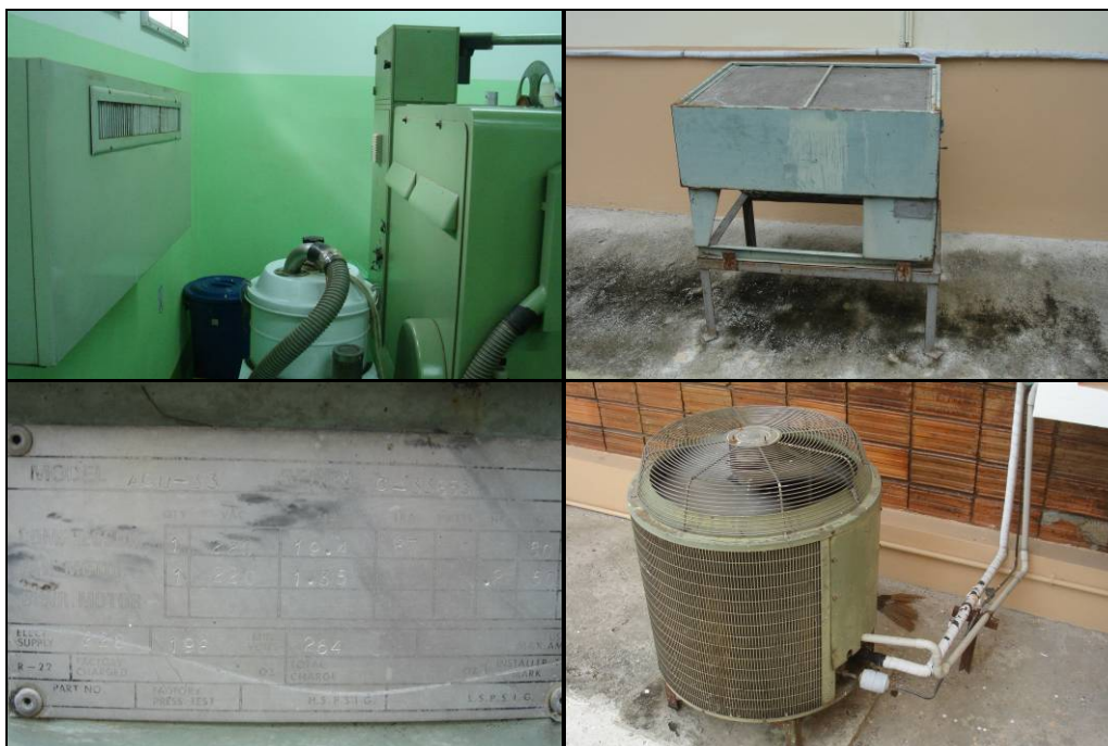
ภาพแสดงระบบเครื่องปรับอากาศของห้องบรรจุของและสำนักงานด้านหน้า
