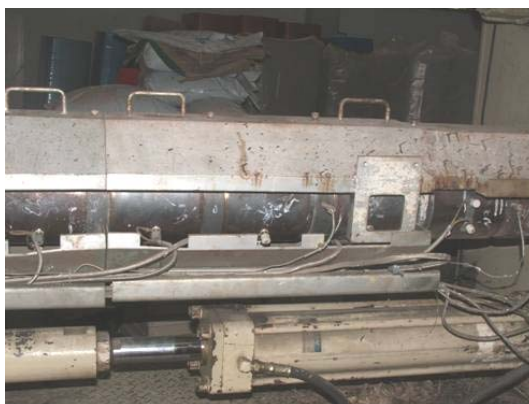
ภาพ Heater ไฟฟ้าขนาด 30 kW ที่ไม่มีการหุ้มฉนวนกันความร้อนสูญเสีย ก่อนปรับปรุง
