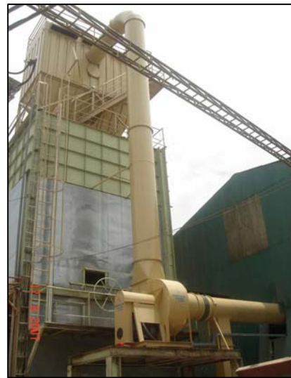
ภาพท่อลมดูดฝุ่นหลังดำเนินการปรับปรุง
