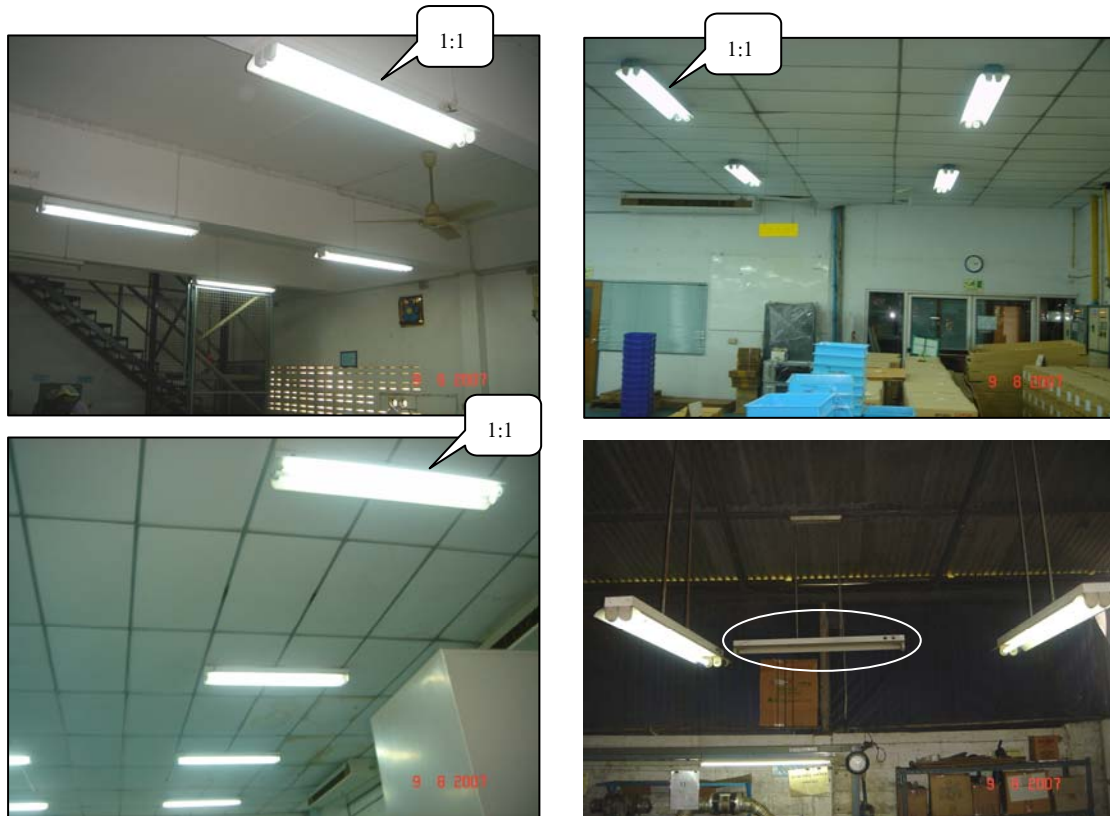
ภาพโคมไฟฟ้า และพื้นที่ที่มีการปรับลดจำนวนโคมไฟฟ้าลง
