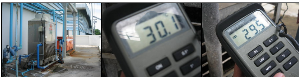
ภาพอุณหภูมิขาเข้าและขาออกของ Cooling Tower หลังจากปิดพัดลม และนำไม้กระดานออก
