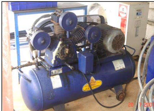
ภาพเครื่องอัดอากาศแบบลูกสูบที่ติดตั้งใช้งานในปัจจุบัน
