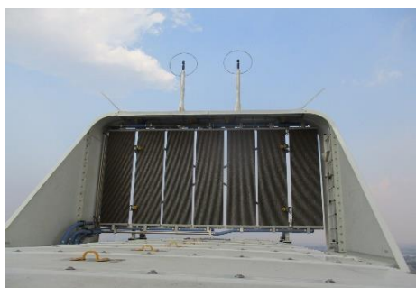
ระบบระบายความร้อน ของเครื่องกำเนิดไฟฟ้า และ Gear box
