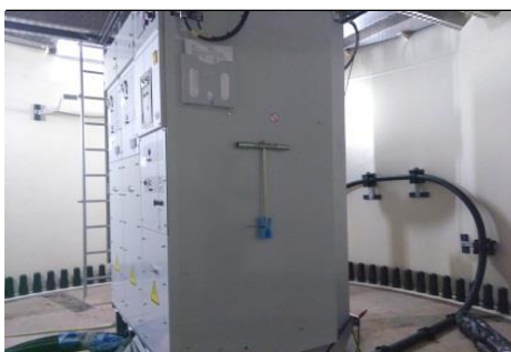
ระบบสายส่งใต้เสาลม
