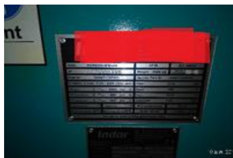
แผ่นป้ายบอกหมายเลขประจำเครื่อง (เห็นว่าติดตั้งตรงไหน)
