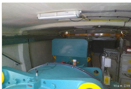
ห้องเครื่องกังหันลม (NACELLE)
