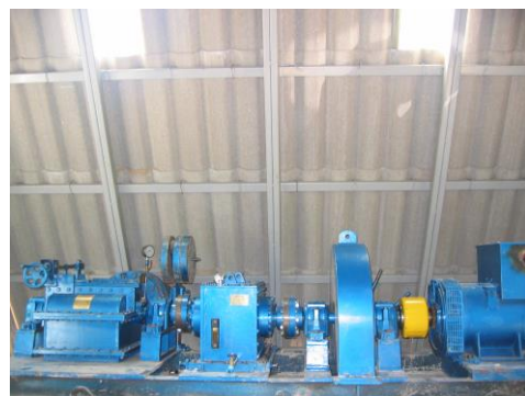
เครื่องกังหันน้ำและเครื่องกำเนิดไฟฟ้า
